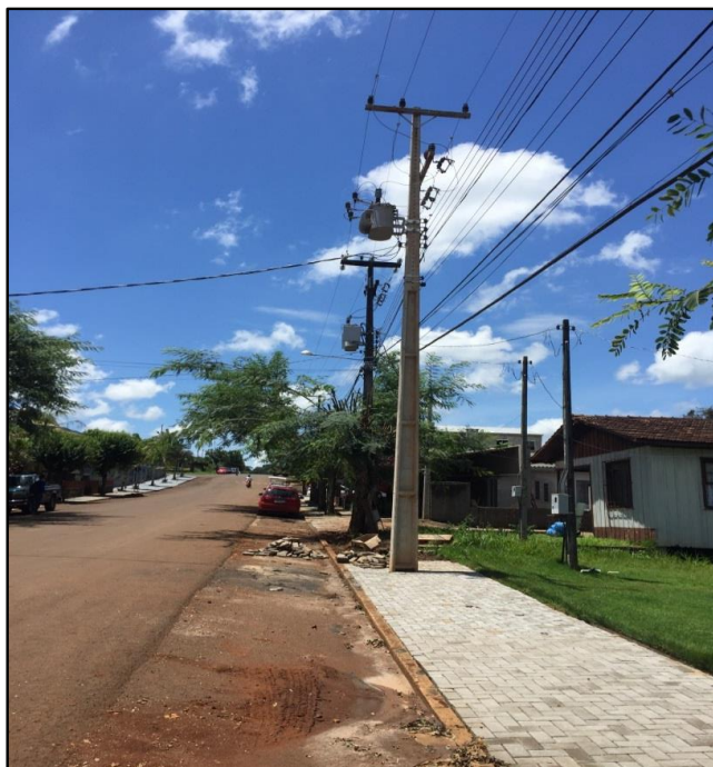
Figura 19 – Árvore com poda inadequada, em conflito com a rede elétrica.
