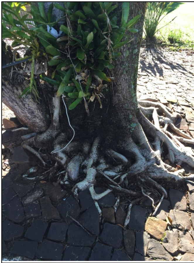
Figura 15 – Árvores com Raízes Superficiais danificando calçadas.
