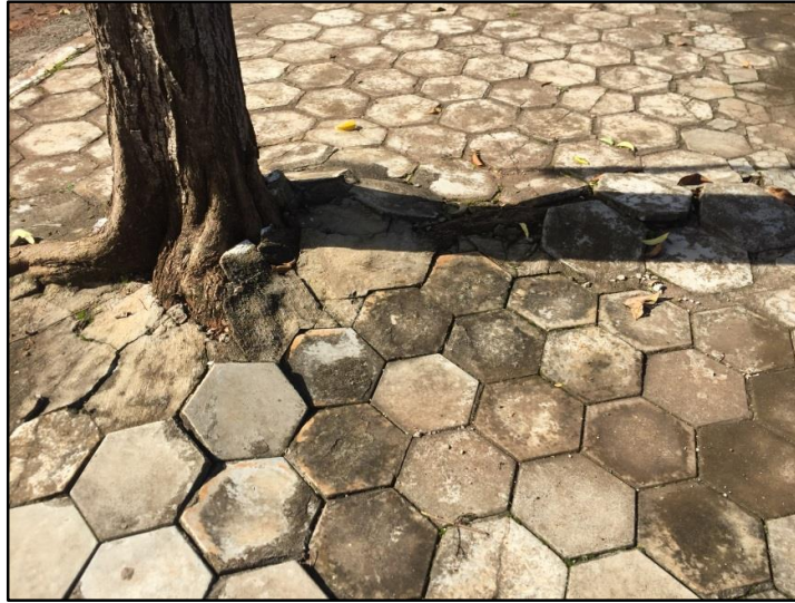
Figura 12 – Árvores com raízes superficiais danificando calçadas.
