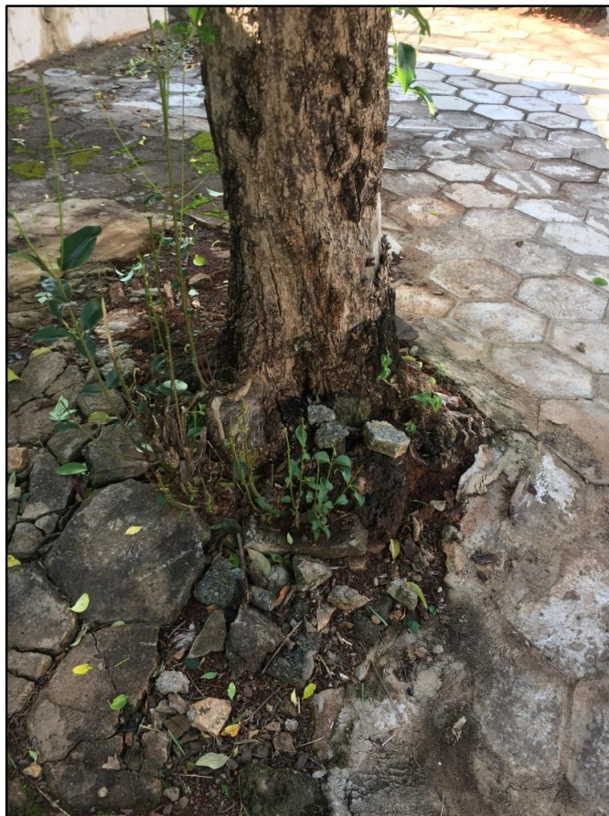
Figura 13 – Árvores com Raízes Superficiais danificando calçadas.
