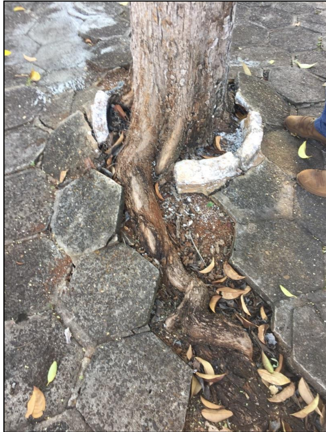
Figura 14 – Árvores com Raízes Superficiais danificando calçadas.
